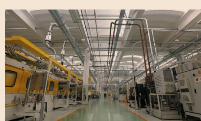
Interno dello stabilimento di Valperga (To)
